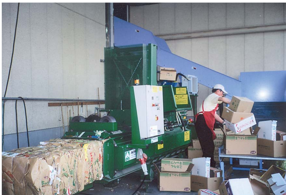
AVOS 88 εγκατεστημένη για συνεχή χειρονακτική τροφοδοσία και πλήρως αυτόματη δεματοποίηση
